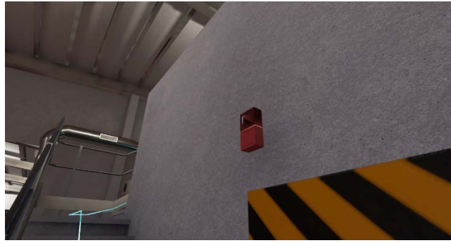
Ilustración 7. El técnico comprueba que la alarma luminosa de sulfhídrico no esté activada
